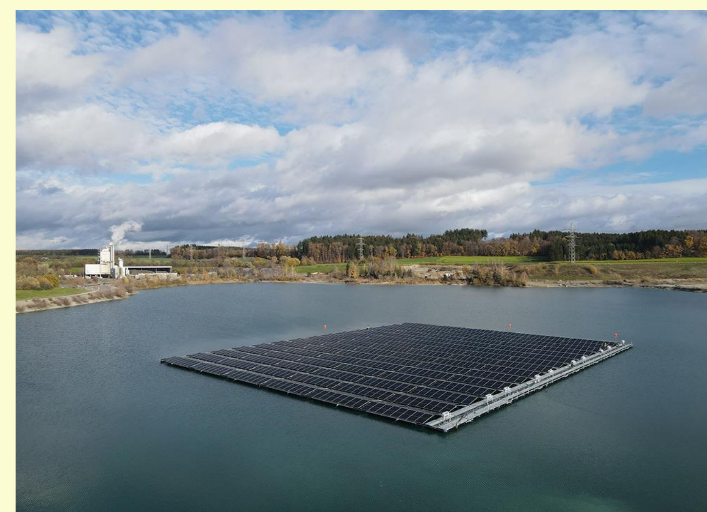
Schwimmende Solaranlage – auf aktiven Kiesbaggerseen Bildquelle: PV Stahlbau Zimmermann
